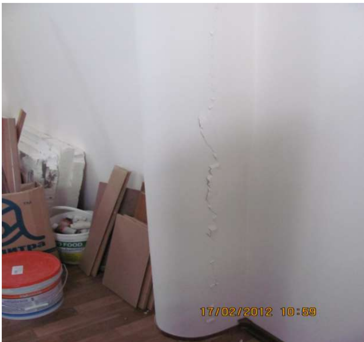
Фото 5 «Фрагмент, характеризующий качество выполненных работ по переоборудованию летней веранды здания МУ «ПМЦ» по адресу: ул. Склизкова, д.52а»
