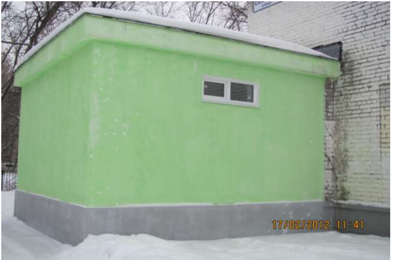
Фото 3 «Внешний вид летней веранды здания МУ «ПМЦ» по адресу: ул. Склизкова, д.52а после ремонта»
