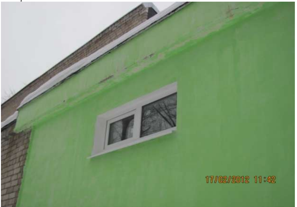
Фото 4 «Фрагмент внешних стен, характеризующий качество выполненных работ по окраске внешних стен летней веранды здания МУ «ПМЦ» по адресу: ул. Склизкова, д.52а»
